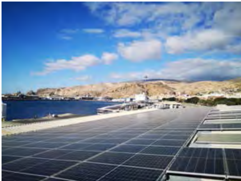
Instalación fotovoltaica instalada en la cubierta de la Estación Marítima del Puerto de Almería
