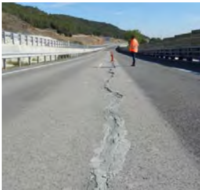
Grietas en el firme en la calzada derecha
