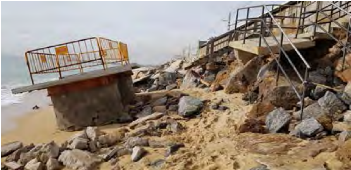
Vista de la erosión de la playa y destrucción del muro costero en Montgat (Barcelona) después del paso de la borrasca Gloria
