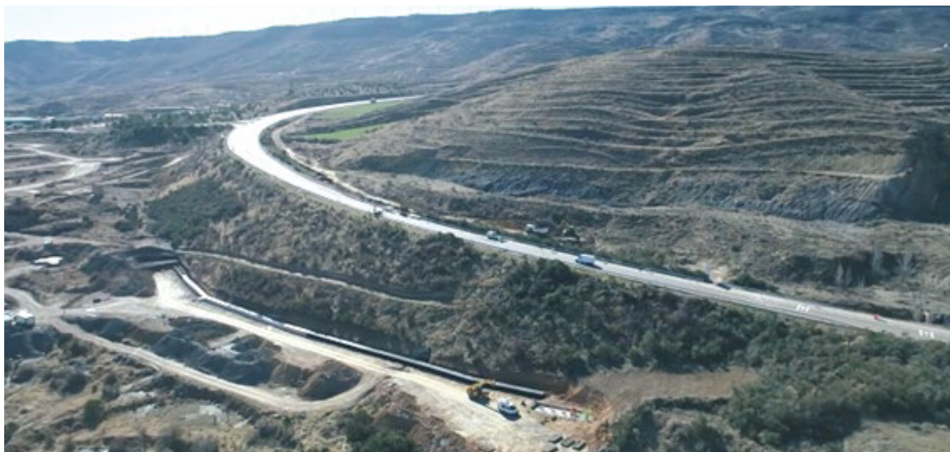
Vista del tramo de la N-420 con patología de naturaleza geotécnica
